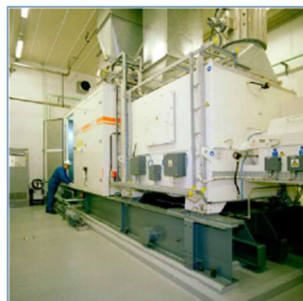
Gas Turbine bulderhus med støj dæmpning og døre til hver sektion.
